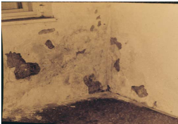
Takto vypadala promáčená stěna, o podlaze nemluvě
